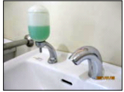
【自動水栓になったトイレ洗面台】
