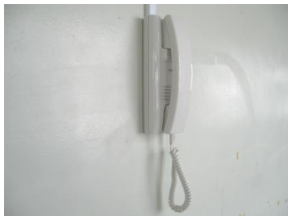
非常通報用インターホン
